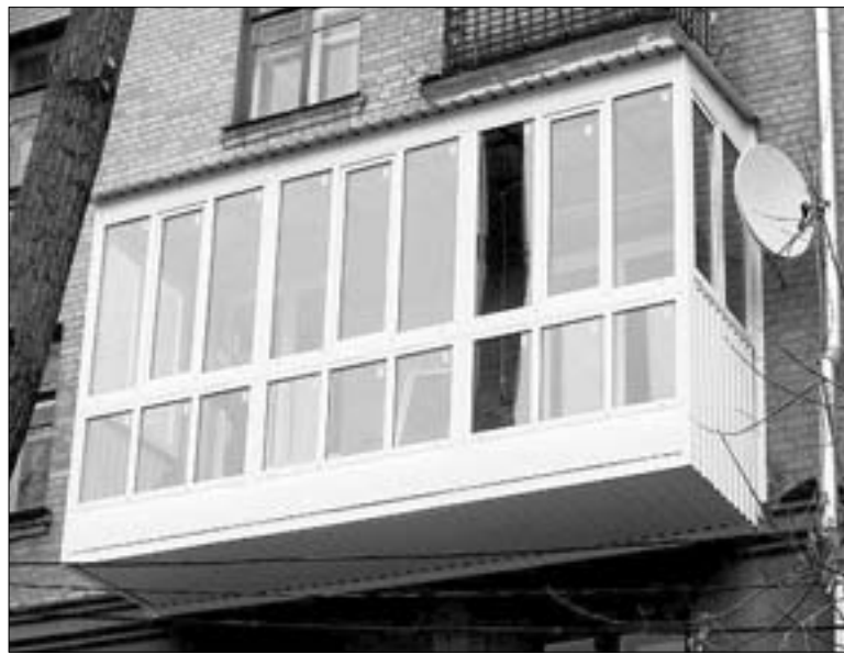
☞ Вот такой балкон-мутант был замечен в одной из многоэтажек Краснодара. Подобные перепланировки строго запрещены - их никогда не согласуют в департаменте архитектуры. / ФОТО: ПРЕДОСТАВЛЕНЫ ЧИТАТЕЛЯМИ
